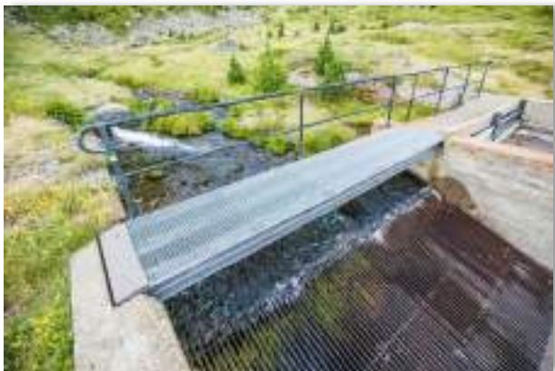
Grille de la prise d’eau de la Courmette d’Espagne (© L. Poudré)
