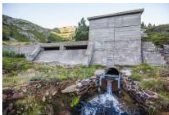
Débit réservé de la prise d'eau de la Coumette d'Espagne (© L. Poudré)
