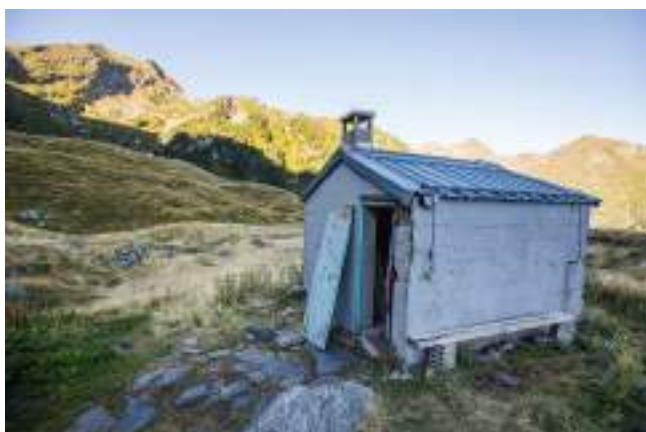
Cabane de la jasse de Delà (Mourtès), nécessitant une restauration
